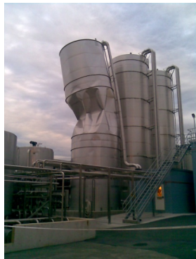
enceinte sous pression
